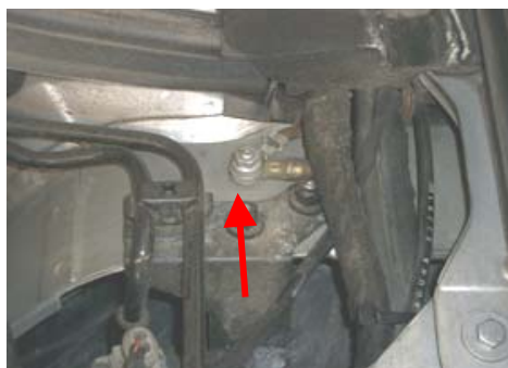
punkt łączenia z masą - lewy
