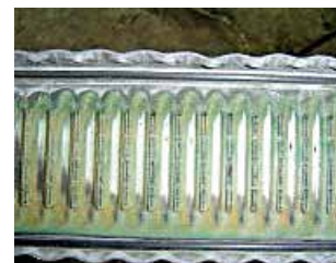
Kalkablagerung durch Verwendung von reinem Wasser (ohne Kühlmittel).
